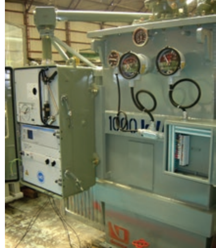
Transformador con cambiador automático
